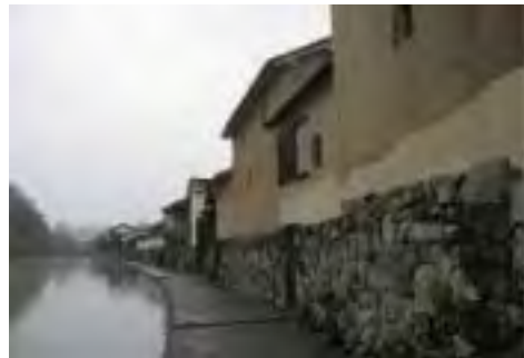
低水護岸のすぐ上の壁色の違う部分が修復の跡
